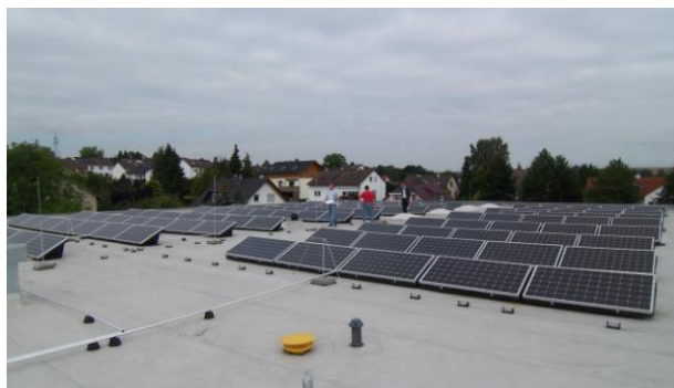
Solarmodule auf dem Dach
